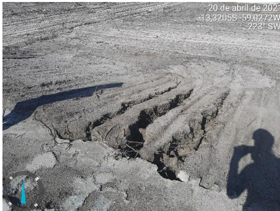
Foto 19 - Monitoramento dos processos erosivos.
