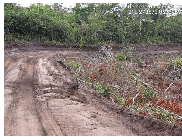
Foto 22 - Monitoramento dos processos erosivos em vias de acesso.
