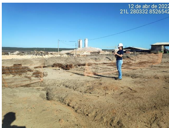
Foto 17 - Monitoramento dos processos erosivos.
